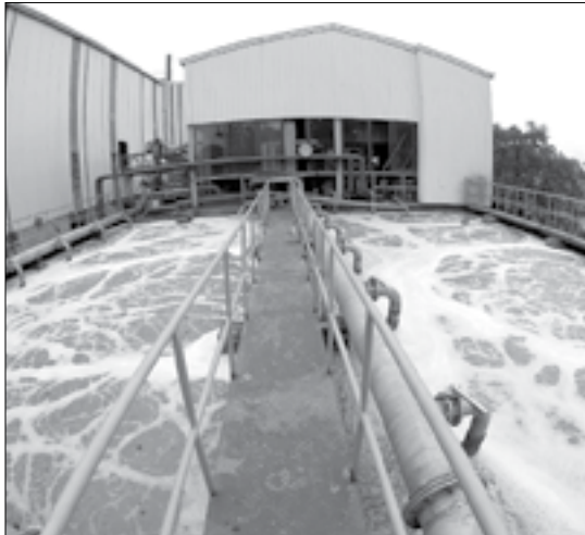
▲ Hệ thống xử lý nước thải của Công ty
