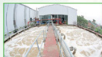
Hệ thống xử lý nước thải của Công ty CP Miza.
